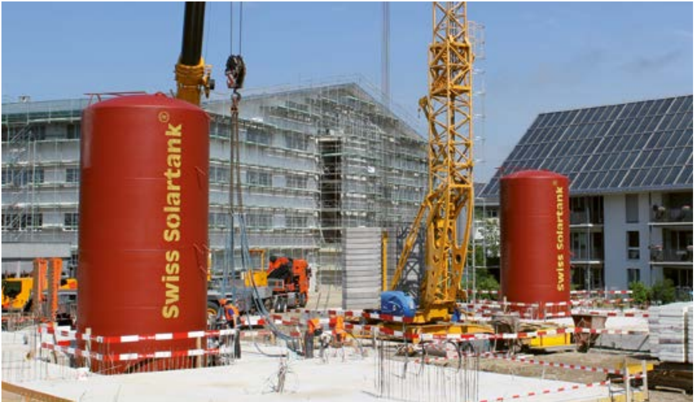
Beitrag zum Klimaschutz und zur Energiewende: zwei 100 % solarbeheizte Mehrfamilienhäuser mit je einem Swiss Solartank à 111 000 Litern auf dem Firmengelände in Burgdorf.
