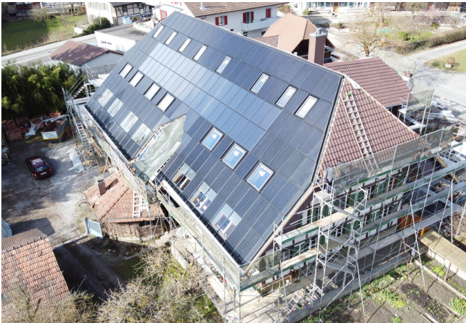
renoviertes Bauernhaus, Urtenen-Schönbühl, Kombination mit Solarwärme
