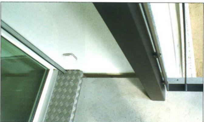
Détail de construction: les balcons sont déconnectés de la façade afin d'éviter toute interruption dans l'isolation.
